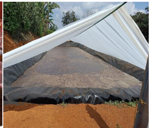
Fosa para tratamiento de aguas residuales con cubierta de membrana y aérea
